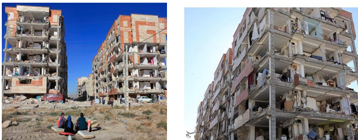
Рис.6. Повреждения высотных зданий при Иранском землетрясении 13.11.2017 г.
